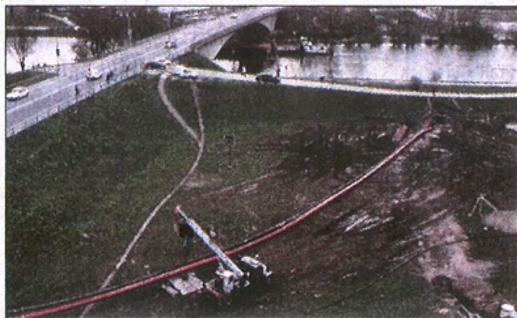
Cestný most ponad rieku Váh v Komárne je už preťažený, inžinierske siete bolo treba viesť pod korytom. 230 metrov dlhý mikrotunel v sebe „skrýva“ až 5 potrubí.
