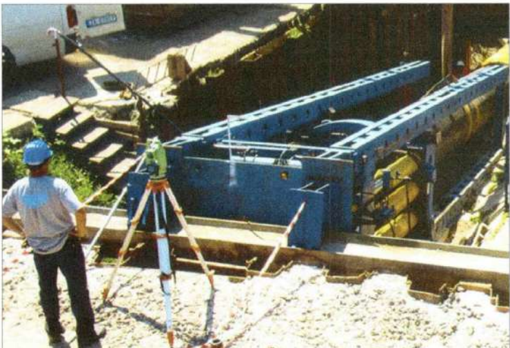
Foto 2 - Pretlačanie priamo vysokotlaktej plynovodnej rúry 1220 x 22 mm do malého rádiusu len 350 m pod riekou z pilotnej štartovacej jamy
