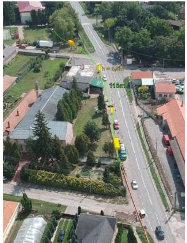
Obr.5. Kanalizácia zhotovená v hornej časti do oblúku R=40m medzi štartovacou jamou s budúcou šachtou a šachtou 5,5 m hlbokou.
